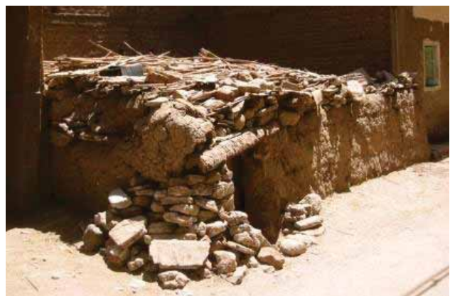
شكل (٢٢) المباني الرديئة بالمدينة
