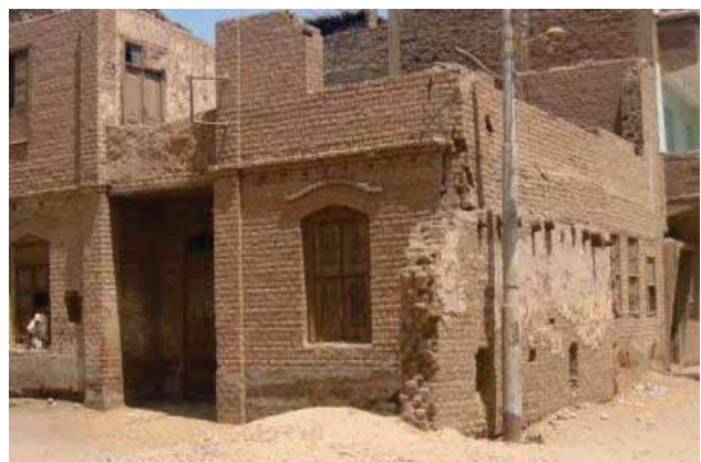
شكل (٢٣) المباني الرديئة بالمدينة
