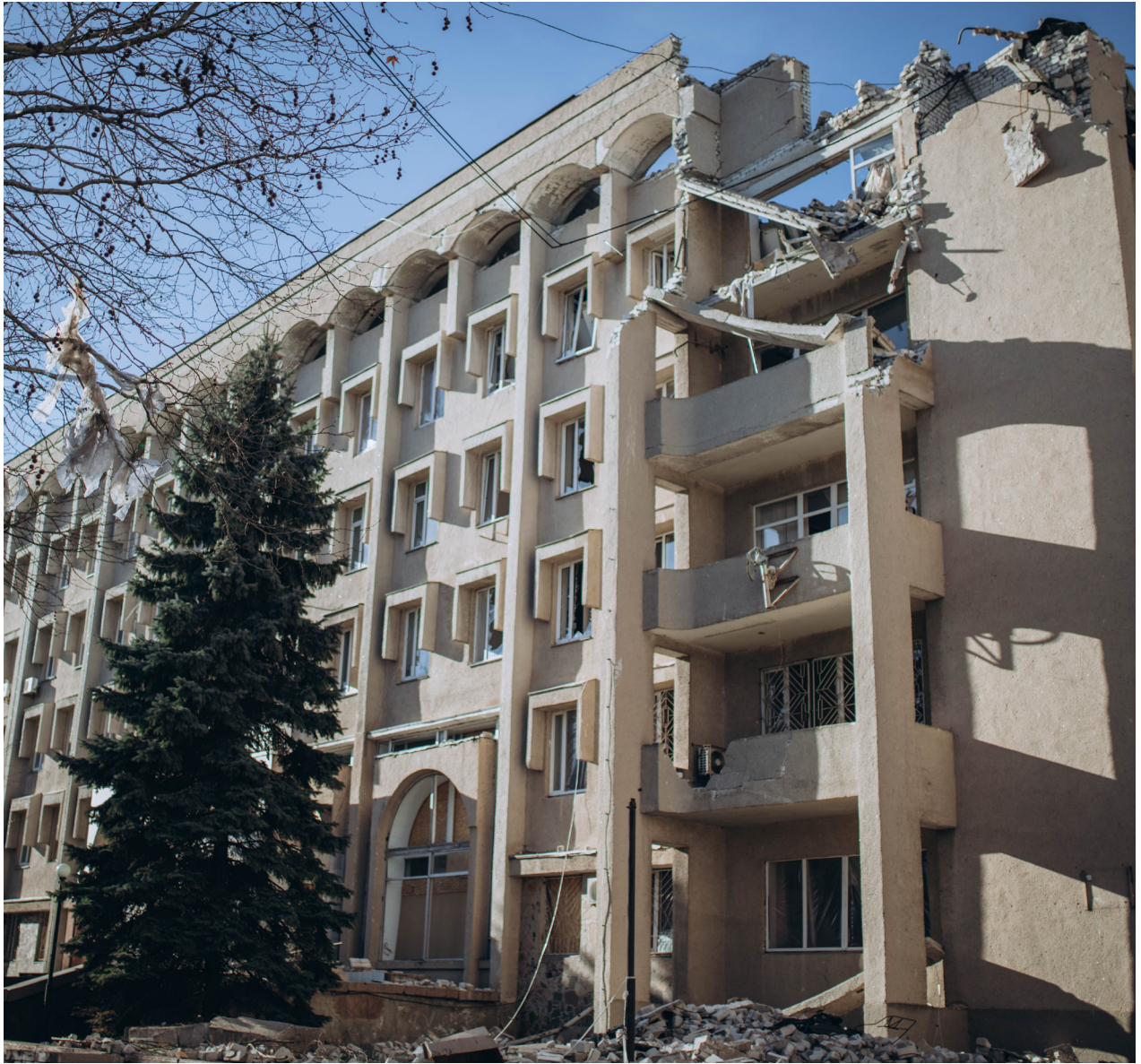
Пошкоджена війною будівля університету, Миколаїв © Jane Zh / Shutterstock
