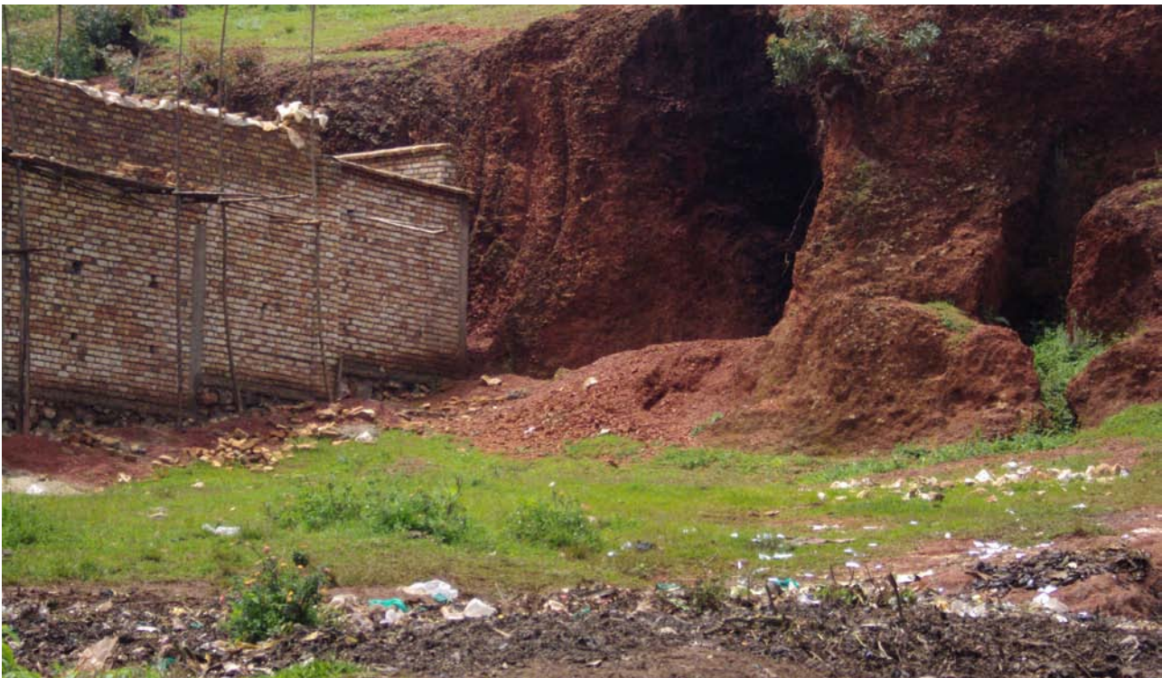
Pollution de l'environnement dû à l'existence de dépôt d'ordure sauvage et détérioration du milieu à cause des eaux de ruissellement entraînant des glissements de terrain.
